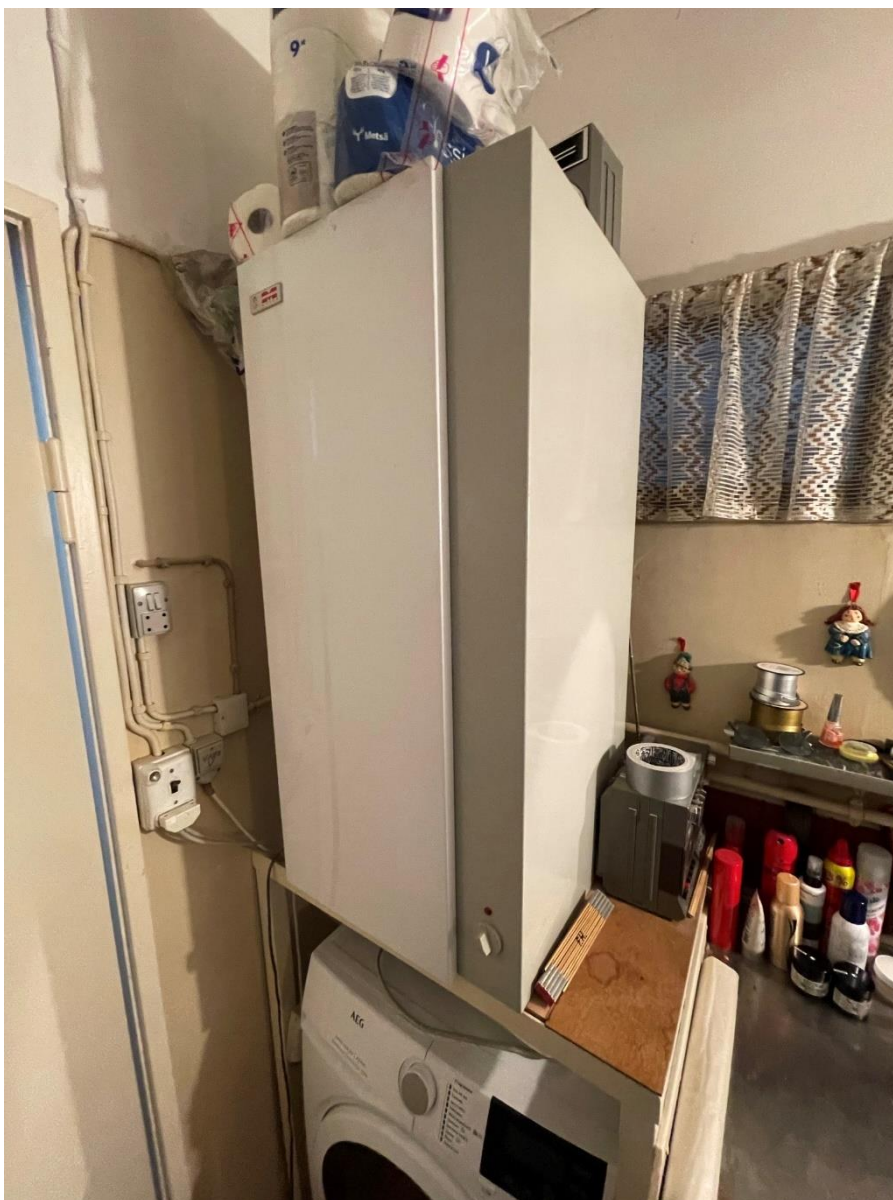
El-varmtvandsbeholder af ældre dato, i nr. 13.
