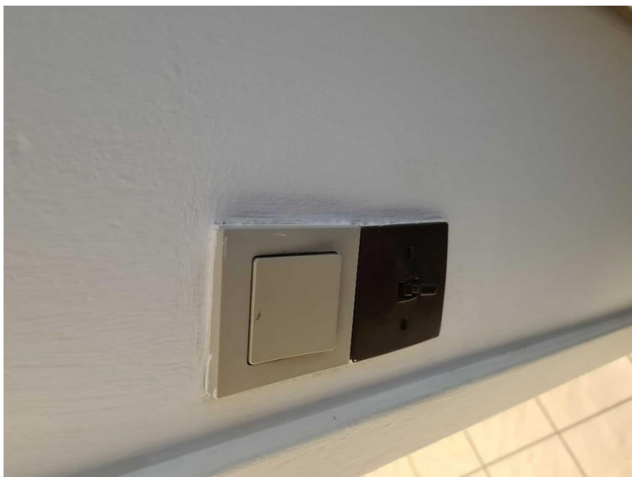
Nr. 8: Nyere og gammel afbryder samlet. Det skønnes at kabling er udført med stofledninger.
