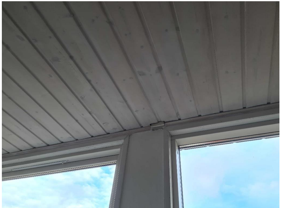
Nr. 147: Ulovlig installation, hvor lampeudtag ikke er tilgængelig.
