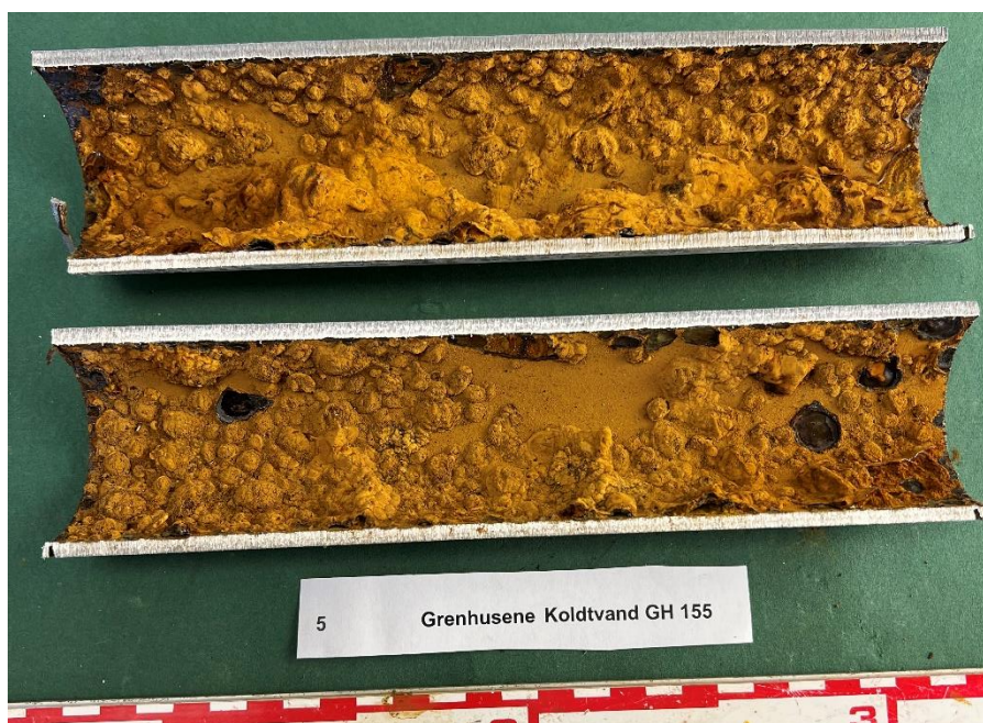
Figur 11 Grenhusene, Koldtvand GH 155. Rørprøve efter langsgående gennemskæring.
