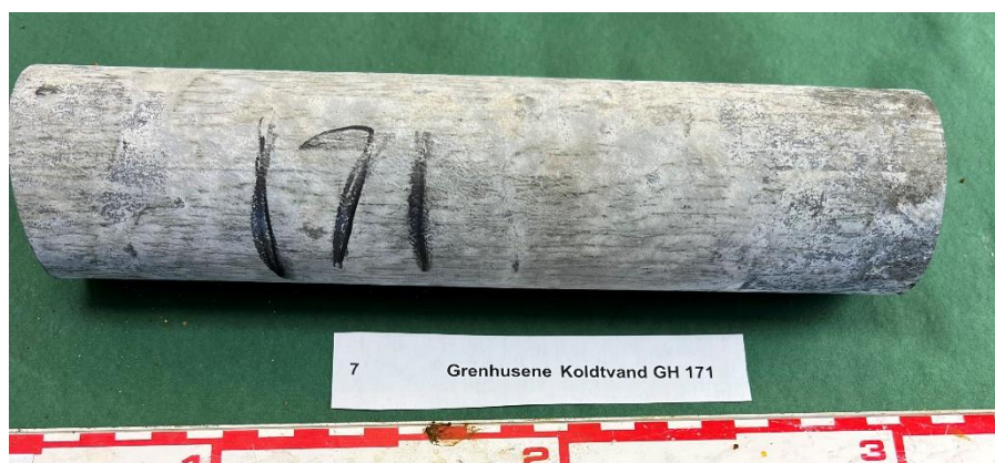
Figur 13 Grenhusene, Koldt vand GH 171. Rørprøve som modtaget.
