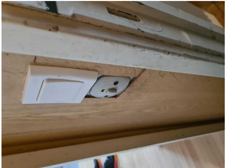
Nr. 33: Nyere og gammel afbryder samlet. Det skønnes at kabling er udført med stofledninger.
