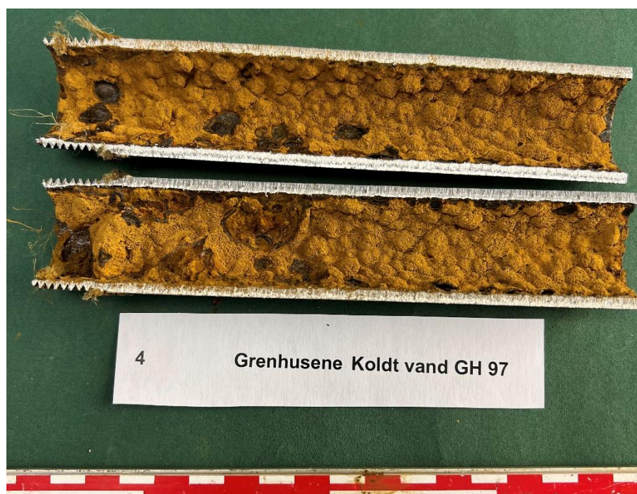
Figur 11 Grenhusene, Koldt vand GH 97. Rørprøve efter langsgående gennemskæring.
