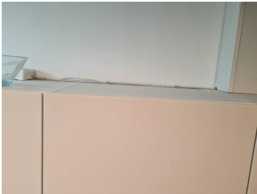
Nr. 60 Ny installation i nyere renoveret køkken.
