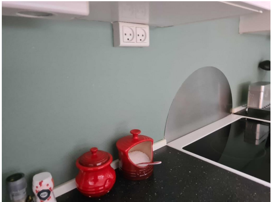
Nr. 8: Ny installation i nyere renoveret køkken.
