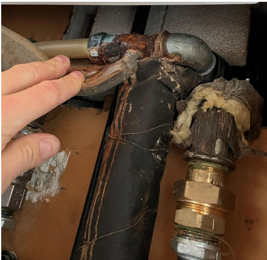
Tæret rør på koldt brugsvand, i skakt i køkken i nr. 13.
