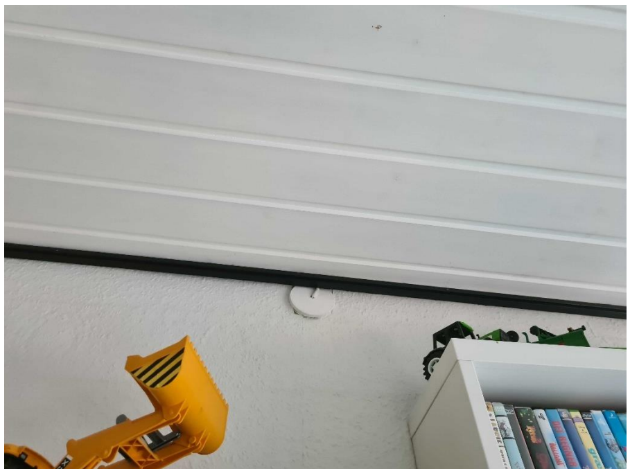
Nr. 100: ulovlig installation, med begrænset adgang til lampeudtag og med tilledning ført over nedsænket loft.
