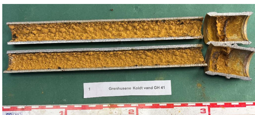
Figur 2 Grenhusene, Koldt vand GH 41. Rørprøve efter langsgående gennemskæring.
