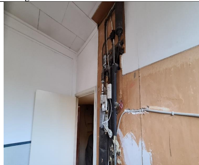
Billede 6: Samling af el-installationer i skakt.
