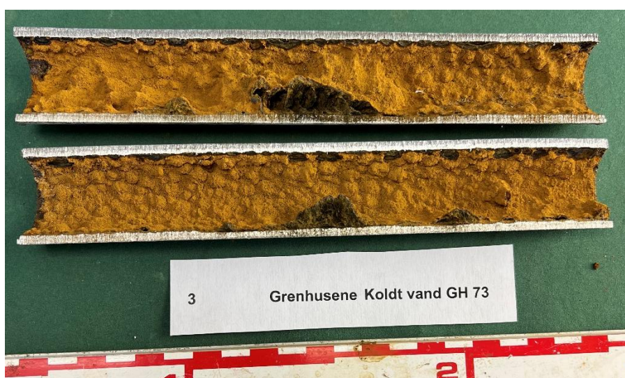
Figur 8 Grenhusene, Koldt vand GH 73. Rørprøve efter langsgående gennemskæring.
