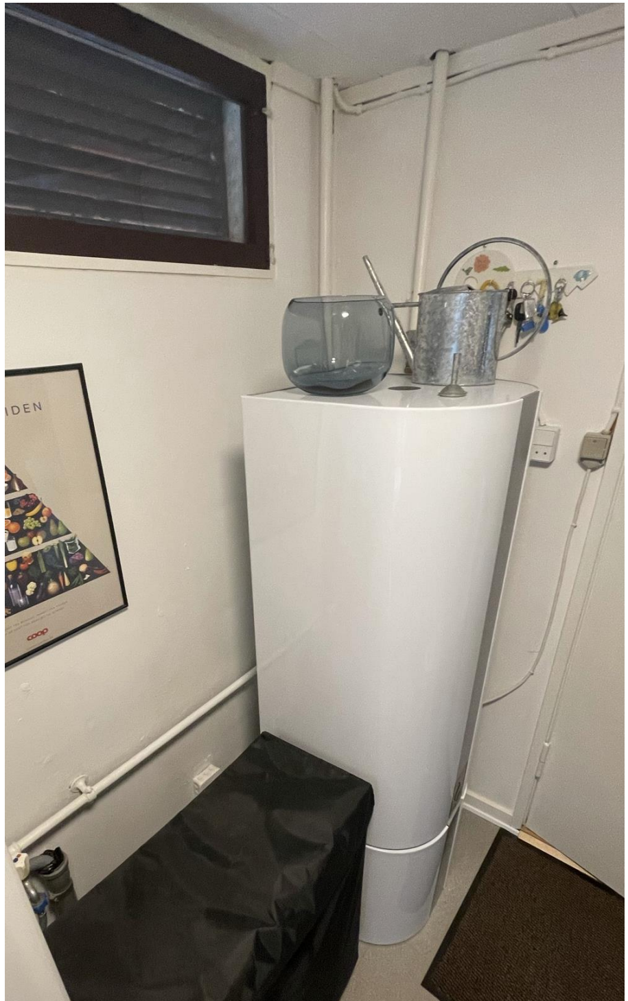
El-varmtvandsbeholder i nr. 8
