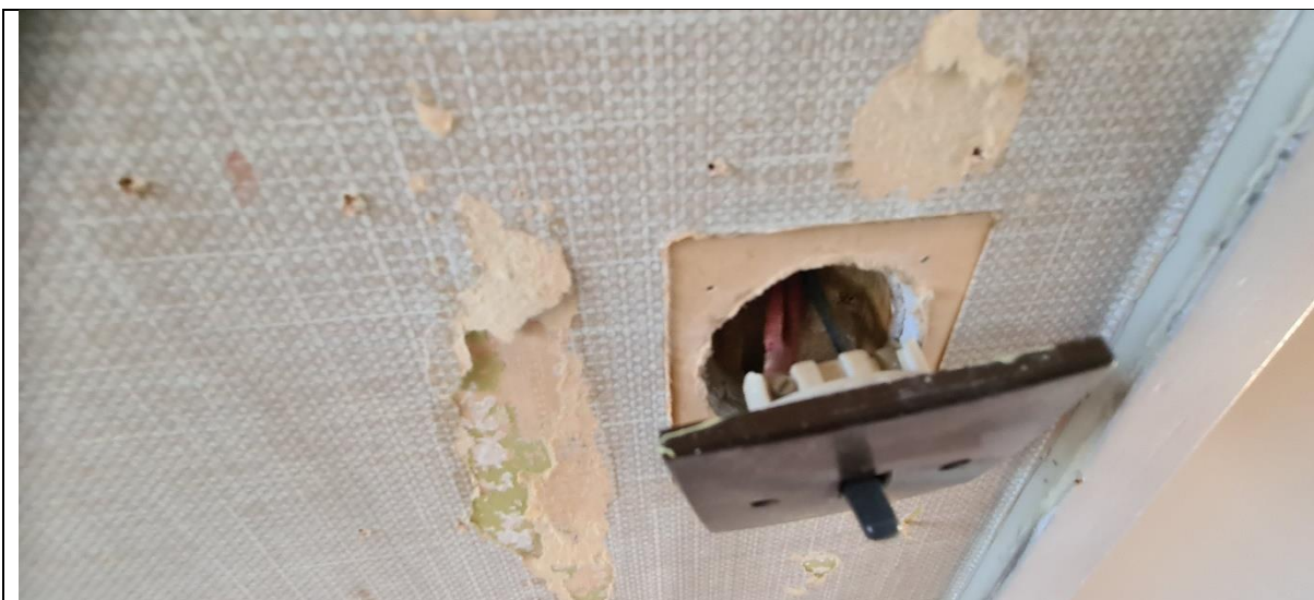
Billede 3: Afbryder fra boligen opførelse og ledninger som stofledninger
