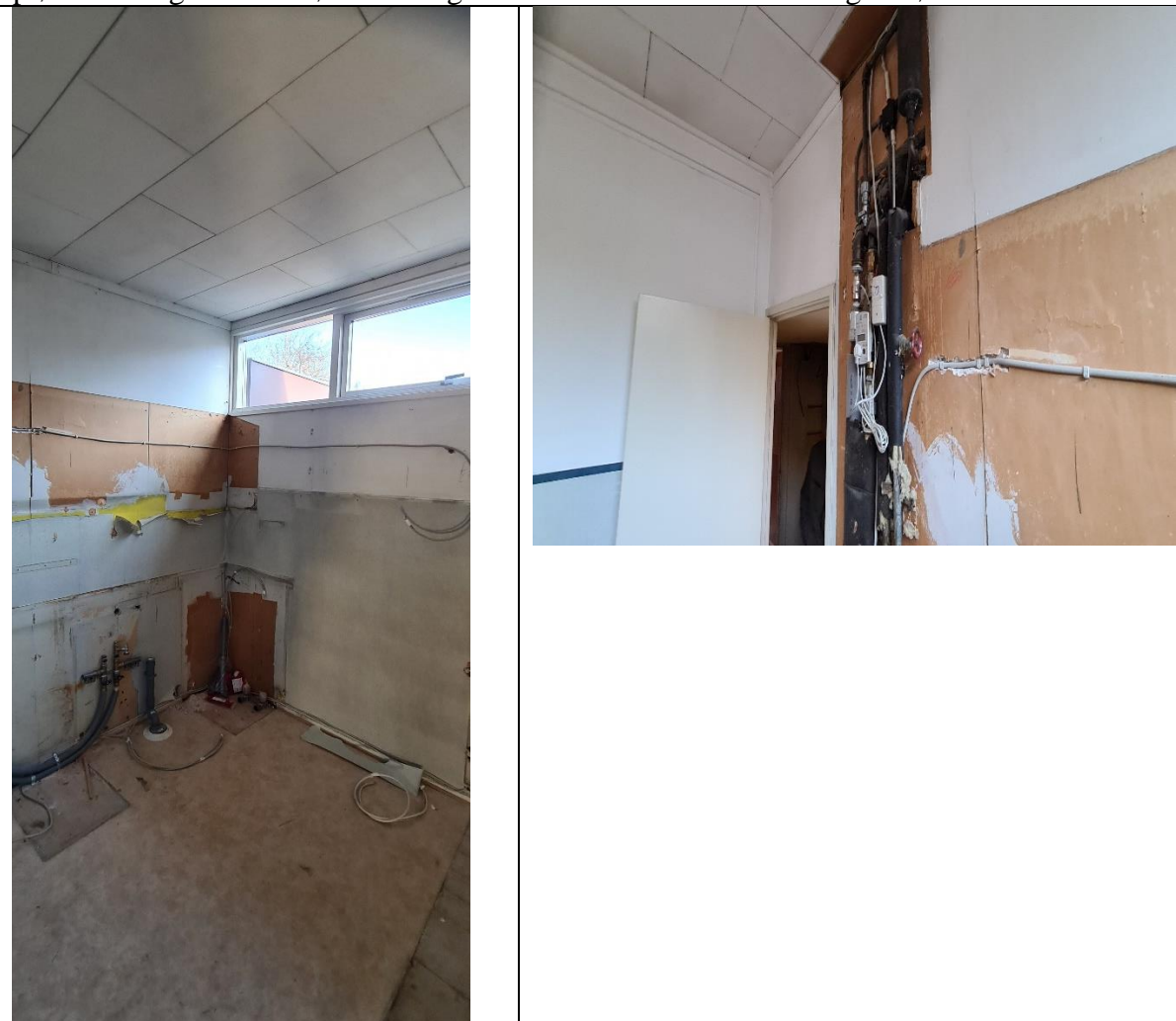
Billede 2: Nyere kabling og skakt i køkken
