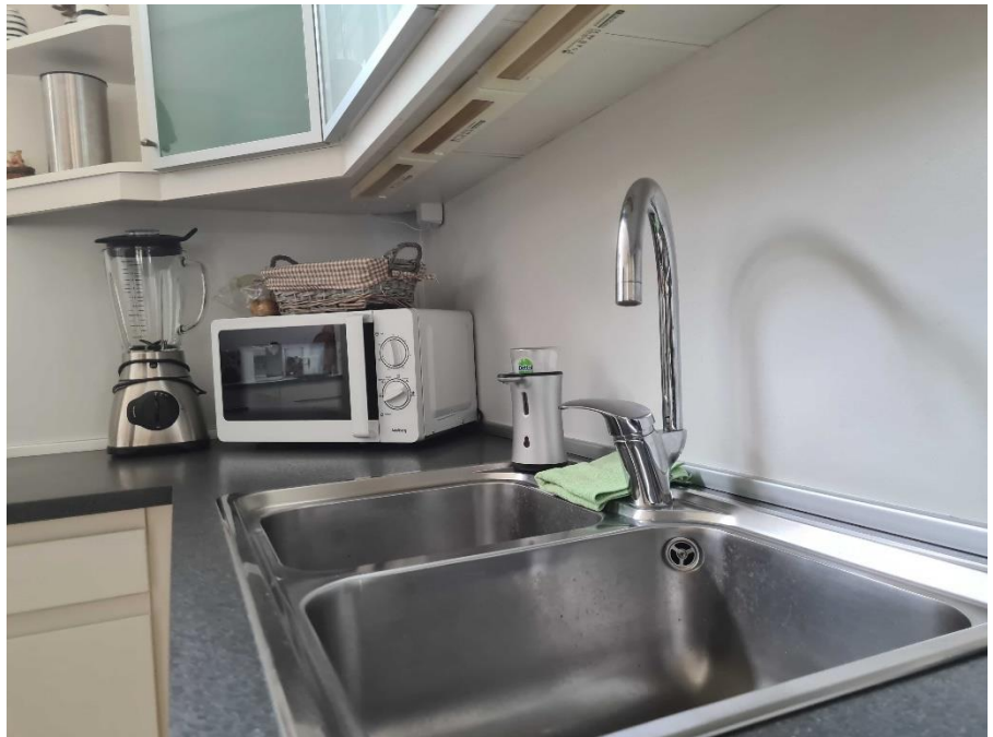
Nr. 61 Ny installation i nyere renoveret køkken.
