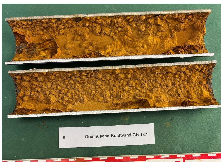
Figur 17 Grenhusene, Koldt vand GH 187. Rørprøve efter langsgående gennemskæring.
