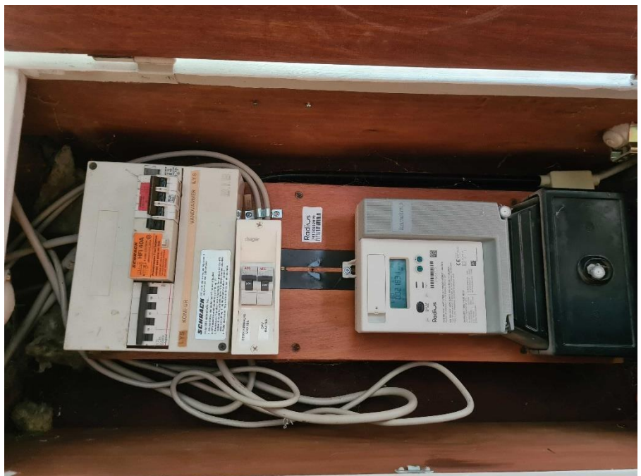
Nr. 60: Ældre gruppetavle, der skønnes at være mere end 30 år. Ulovlig kabling, der ikke er fastgjort til bygningsdel.
